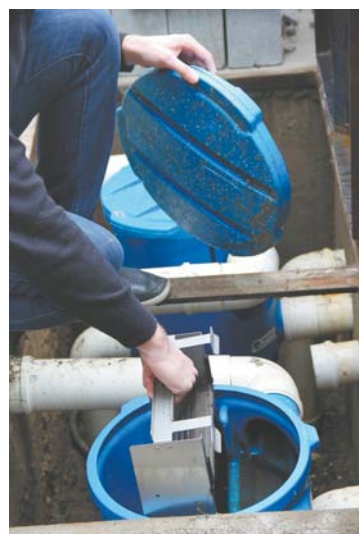
Águas passam por dois filtros
